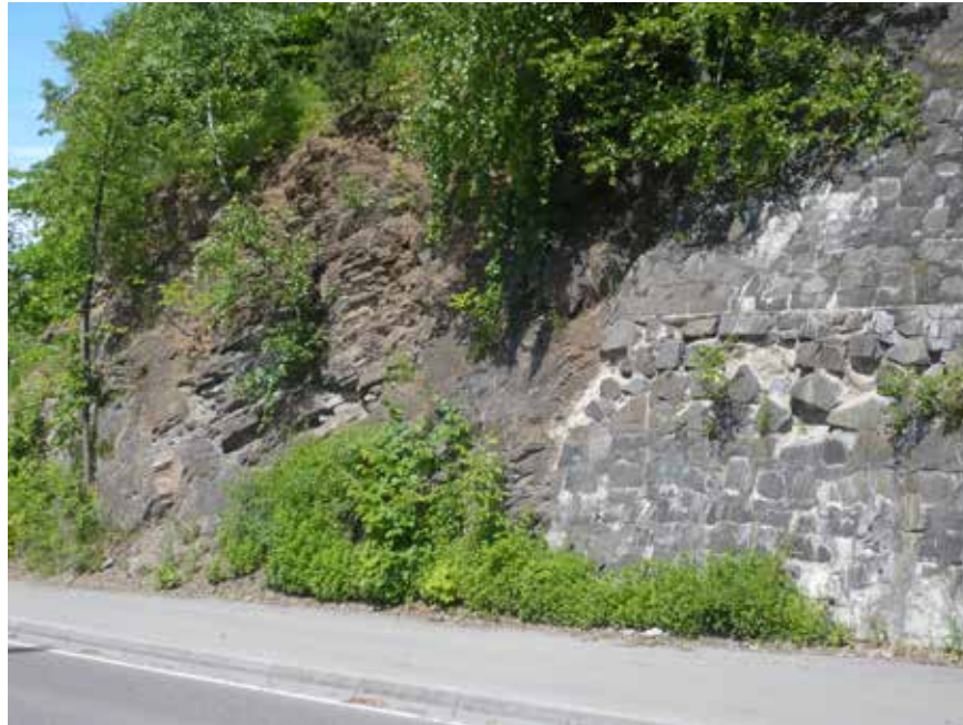
Den ødelagte støttemuren i Hosleveien
